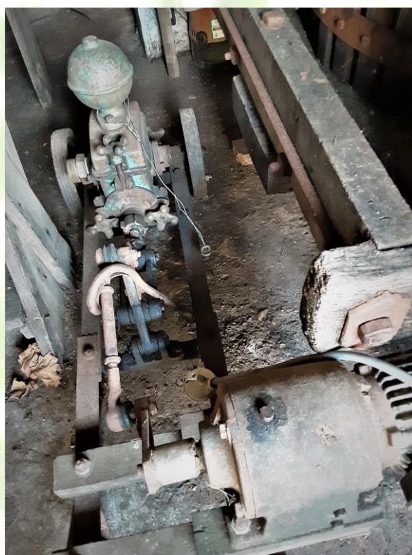
Pompe à bras pour écouler, équipée d'un moteur, dès l'arrivée de l'électricité à Eglise-Neuve, en fonction jusqu'aux vendanges de l'automne 2020. Coll. Pichardie
